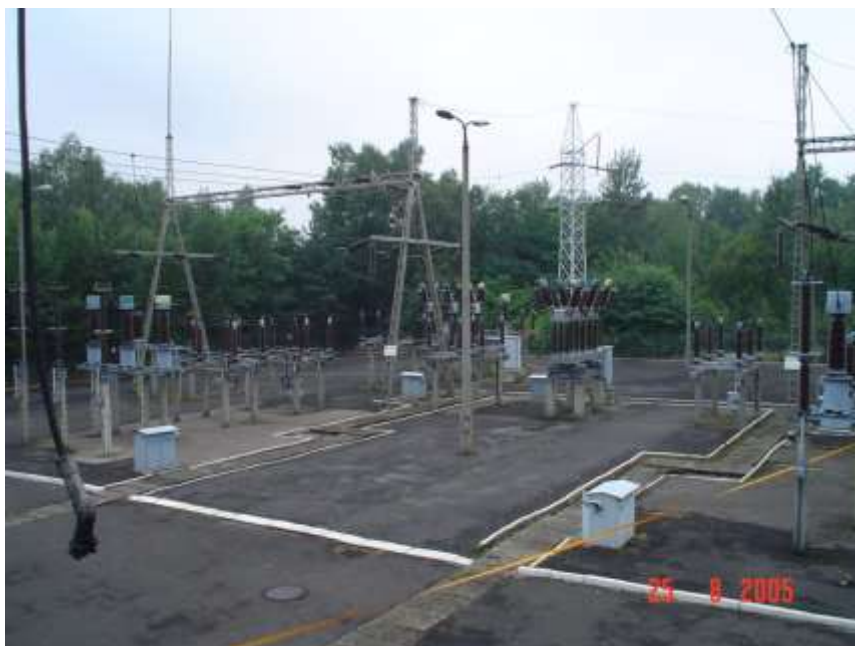
Rys. 2 (Fig. 2) Widok typowej napowietrznej stacji WN (View of typical HV substation)
